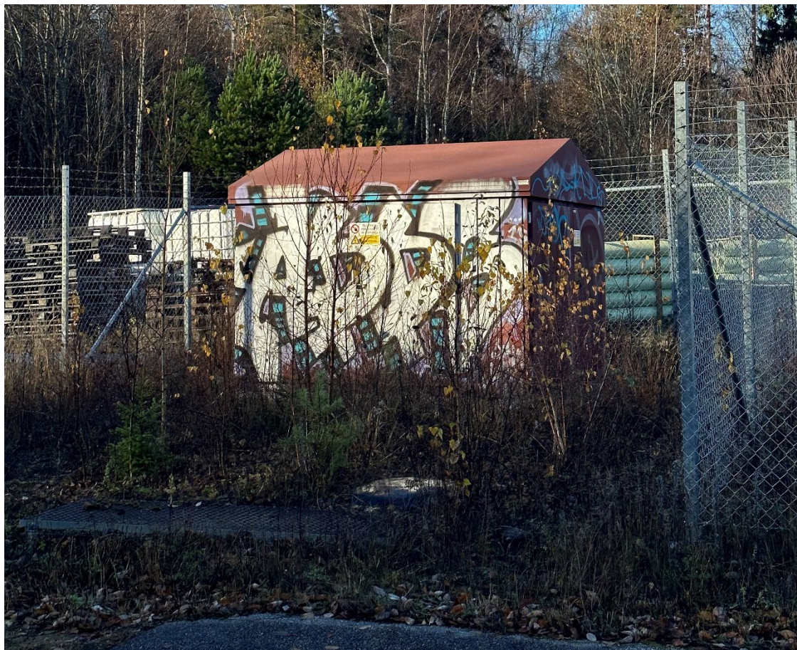
Figur 7: Befintlig transformatorstation. Fotot taget från vägen.
