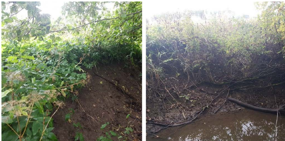
Figur 6. Pågående erosion i ytterkrön i norra delen av Siggbobäcken.
